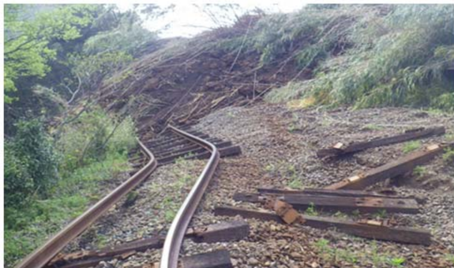
土砂流入終点側・激しい変状 立野駅から1k300m付近～延長約250m
